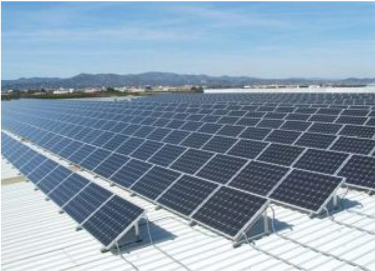
Planta Foltovoltaica (FUENTE: WFW)
